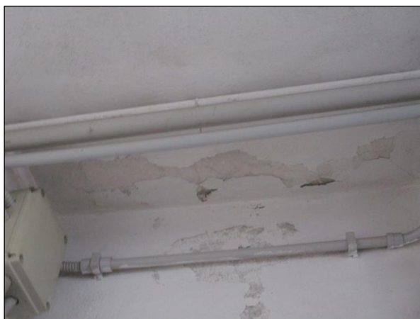
Foto n°20 - Porzione del plafone nel Deposito 1 al piano seminterrato connotata da un grado di aderenza della finitura considerato pessimo.
