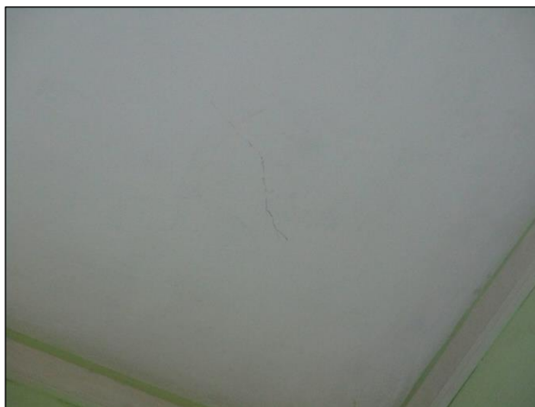
Foto n°19 - Porzione del plafone nell'Aula 3 al piano terra connotata da un grado di aderenza della finitura considerato pessimo.
