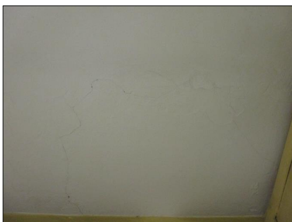
Foto n°22 - Porzione del plafone nell'Aula 1 al piano terra connotata da un grado di aderenza della finitura considerato scadente.
