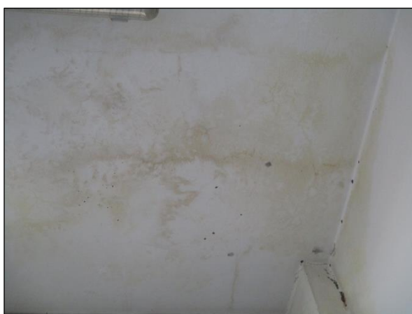
Foto n°23 - Porzione del plafone nel Bagno 1 al piano primo connotata da un'efflorescenza superficiale.
