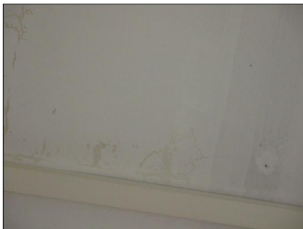
Foto n°18 - Porzione del plafone nell'Aula 2 al piano primo connotata da un grado di aderenza della finitura considerato pessimo.
